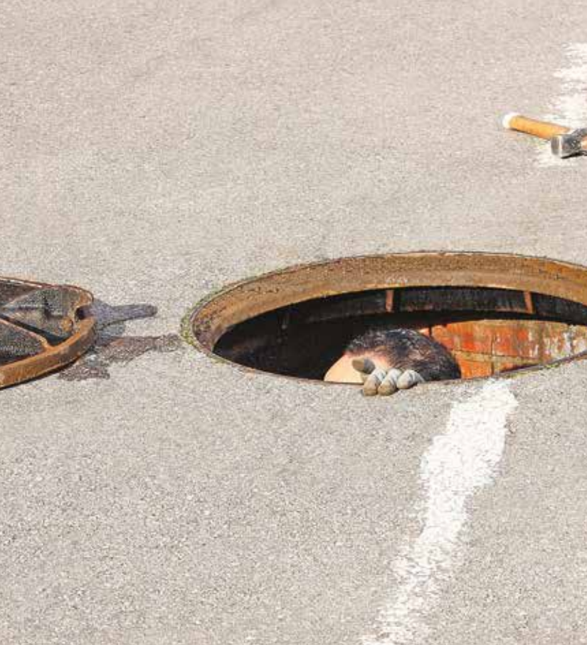
Trabajo en espacios confinados
